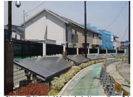
敷地の周りには400mにわたりソーラーパネルが。平常時は売電により街のマネジメント機能を担い、非常時は周辺地域の人々の非常用コンセントとして開放するそうです
